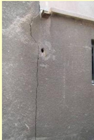
تهیه عکس: ترک در دیوار
