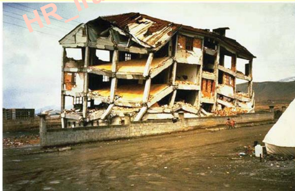
تخریب اتصال در اثر کمبود آرماتور طولی که منجر به تخریب کلی سازه شده
