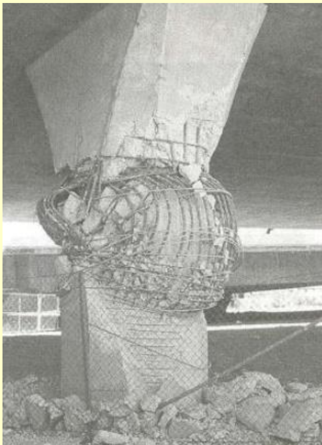
کمانش آرماتورهای طولی زلزله ۱۹۹۴ نورث ریج
