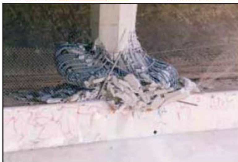
کوماتش آرماتورهای طولی به علت عدم دورگیری مناسب آنها
