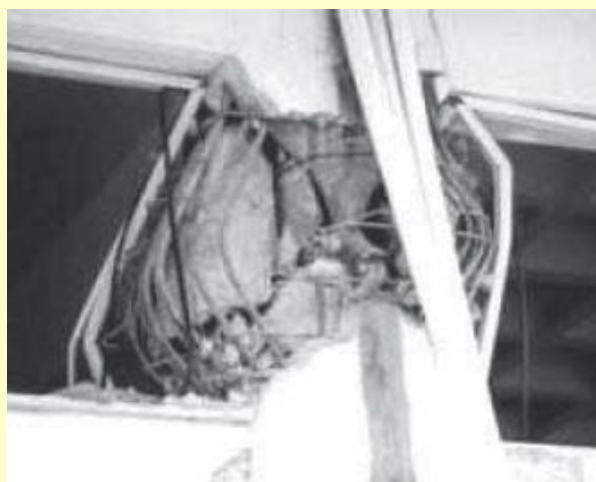
خردشدگی بتن و ترک‌های قطری
