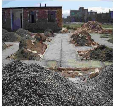
ریختن خاک و نخاله ساختمانی در قسمت‌های خارجی قالب‌های فونداسیون و عدم اجرا بلوکاژ
