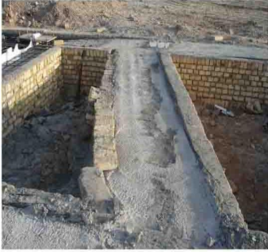
خالی بودن پشت دیواره قالب موقف بتن ریزی و حرکت دیواره قالب و در نتیجه آسیب هندسه فونداسیون بتنی
