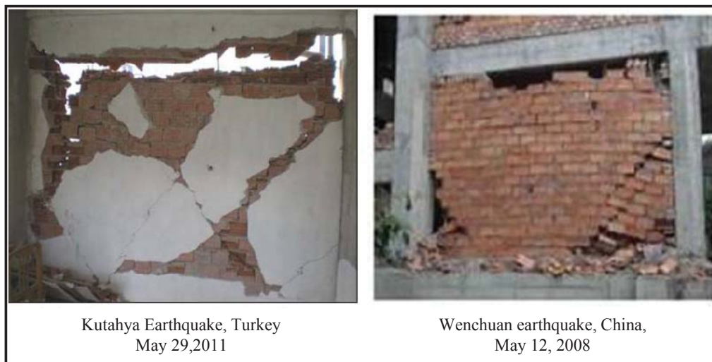
شکل ۱۰-۱- خرابی داخل صفحه میانقاب‌های رسی (سفالی) غیرمسلح در زلزله‌های کوتاهیا و ونچوان
