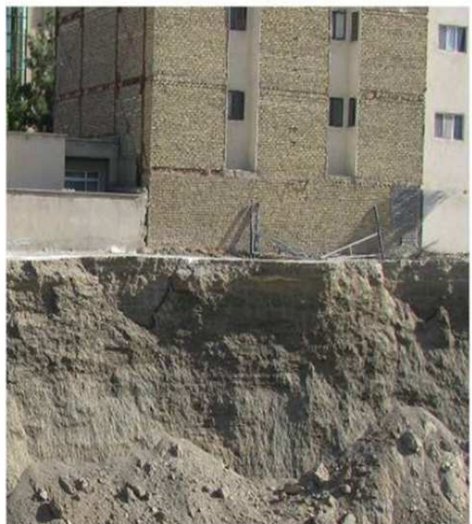
(الف) ترک پیش رونده در مجاورت پی ساختمان مجاور
