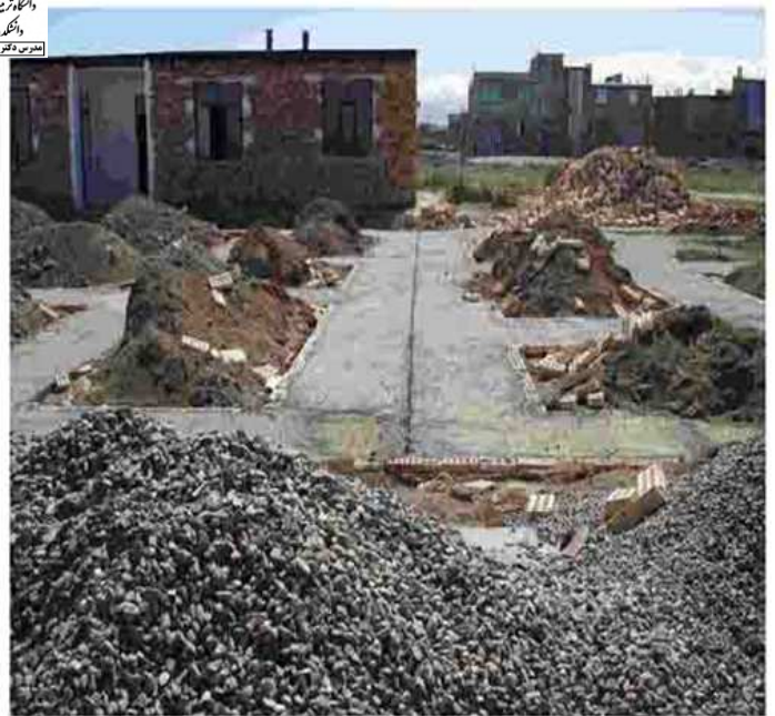
ریختن خاک و نخاله ساختمانی در قسمتهای خارجی قالبهای فونداسیون و عدم اجرا بلوکاژ
