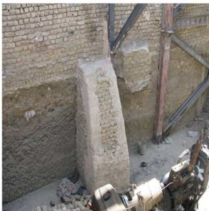
(ب) اجرای سازه نگهدار غیراصولی (منبری) و نشست
