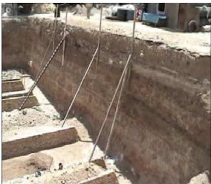
(ب) گودبرداری و سازه نگهدارنده غیر اصولی
