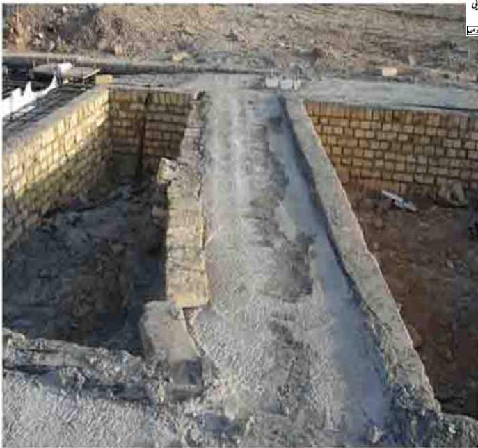
خالی بودن پشت دیواره قالب موقع بتن ریزی و حرکت دیواره قالب و در نتیجه آسیب هندسه فونداسیون بتنی
