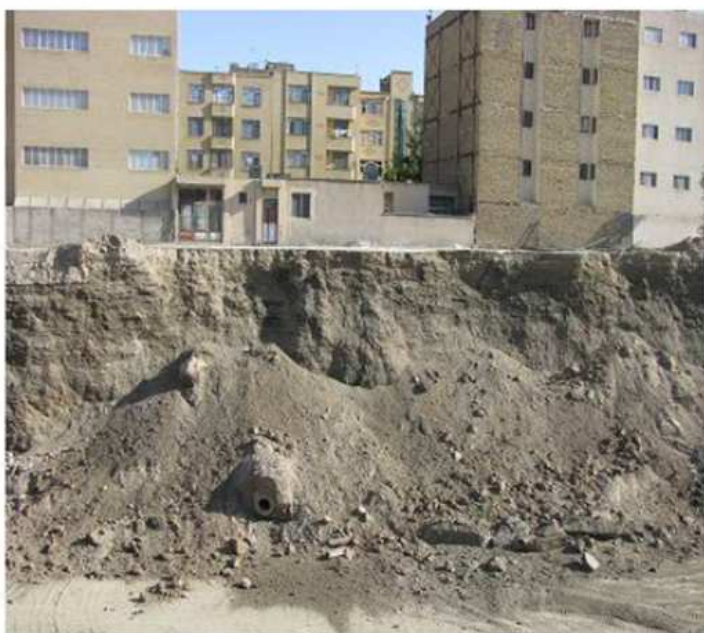
(ب) ریزش دیواره و ایجاد ترک در ساختمان
