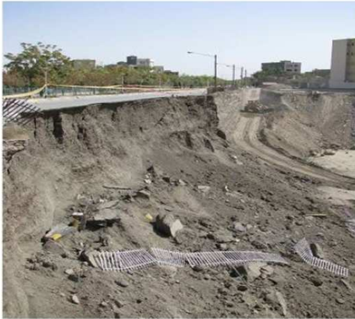
(الف) ریزش دیواره و خسارت به خیابان مجاور
